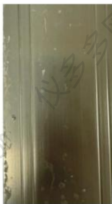
图 B.2 腐蚀缺陷典型示例——未清洗的阳极氧化复合膜表面的点蚀
