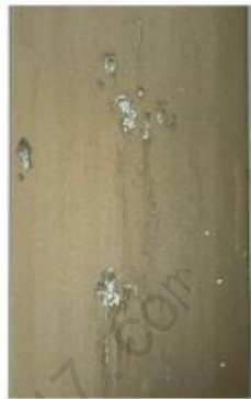
图 B.1 腐蚀缺陷典型示例——未清洗磨砂阳极氧化膜表面的点蚀
